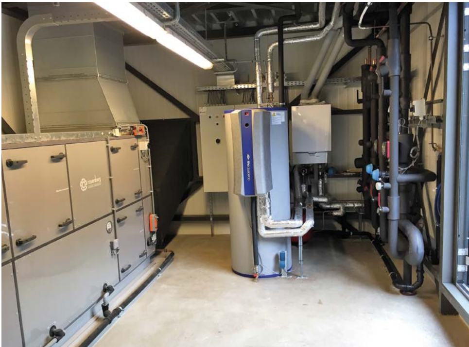
Deel van de techniekruimte met de klimaatinstallatie.
